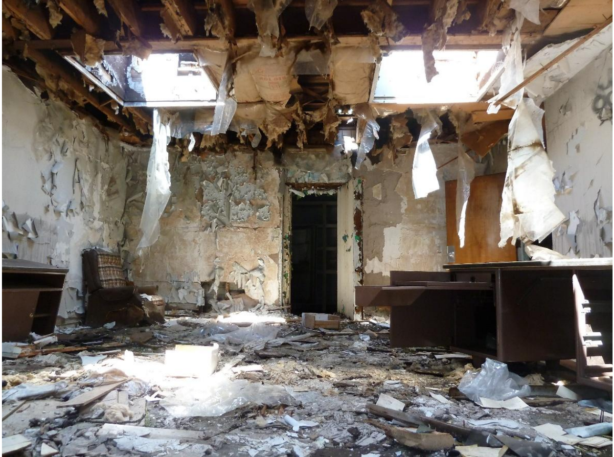
Figure 19. État des lieux suite à la contamination à l'amiante, le squat et l'incendie, Rayside Labossière, 2025.
