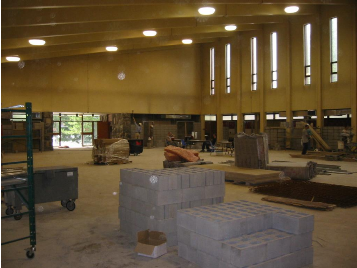
Figure B34. Travaux au niveau de la nef de l'église de Saint-Bernard, Cardin-Julien, 2025.
