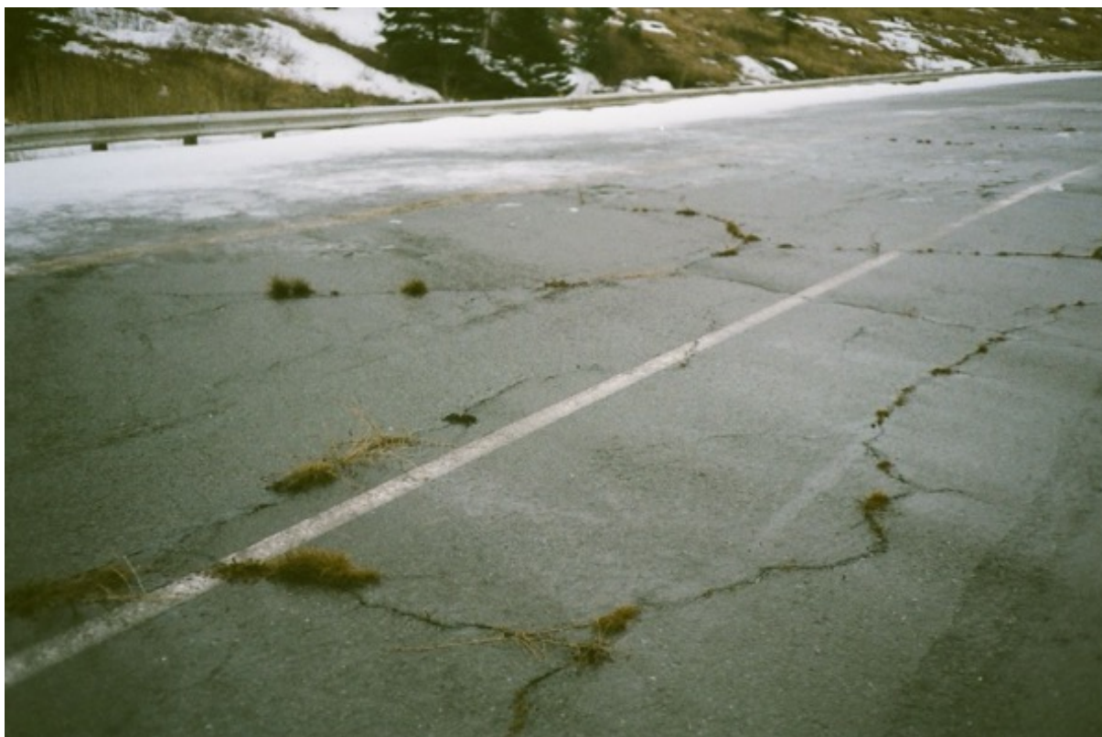
Figure 3.6 Alec White, photographie d'une partie de la route 112 fermée, 2022
