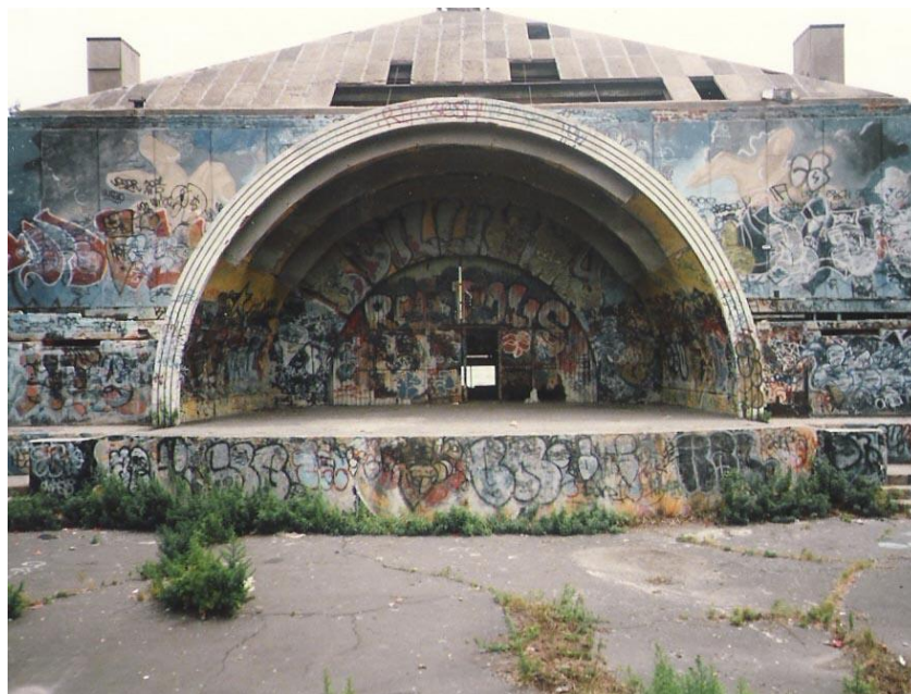
Figure 6.35 Faute d'entretien, l'amphithéâtre atteint un niveau de dégradation avancé au cours des années 1980. NYC Department of Parks Archives
