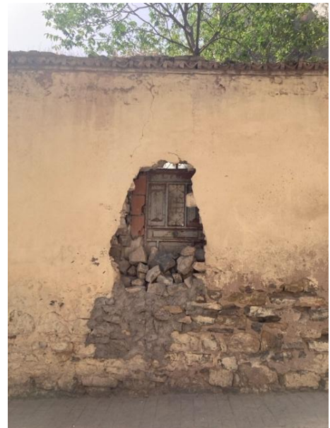
Figure 6-17 Trou dans le mur d'enceinte
