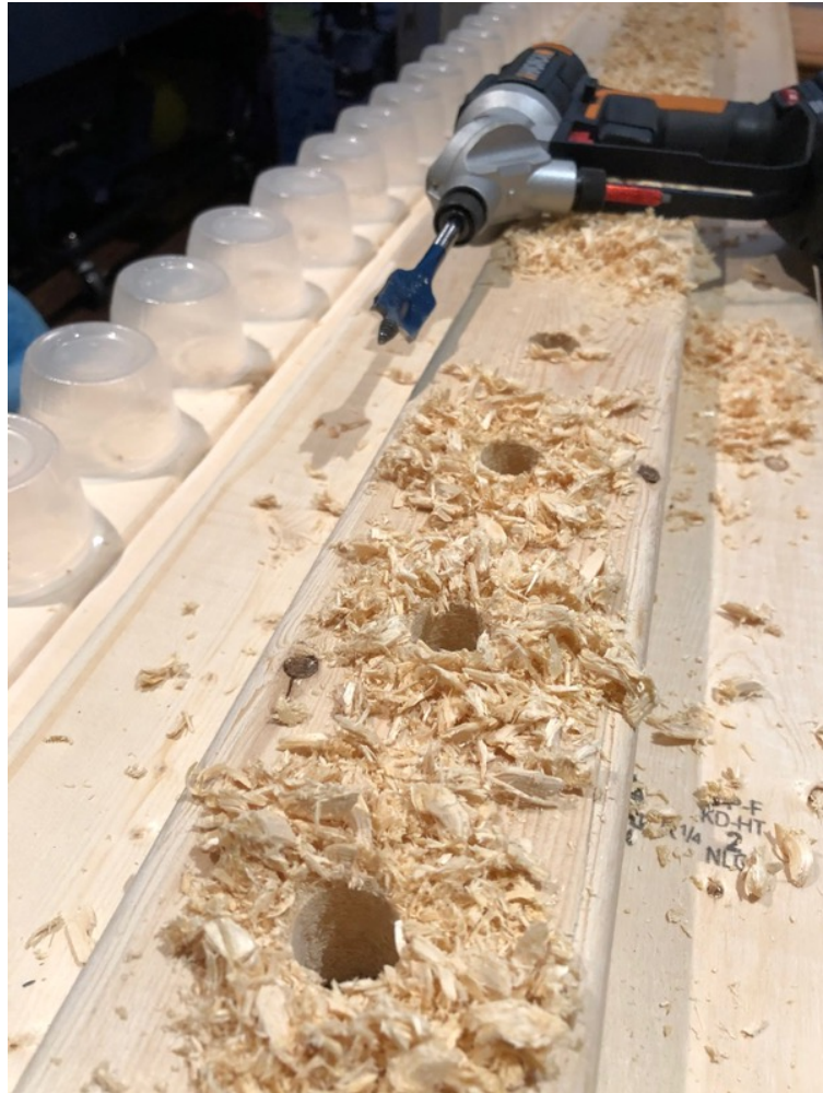
Figure 44 – Préparation de l'installation n° 19.
