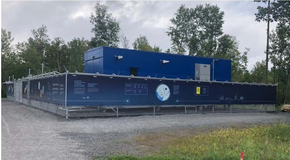
Figure 6.6 Poste électrique du microréseau
