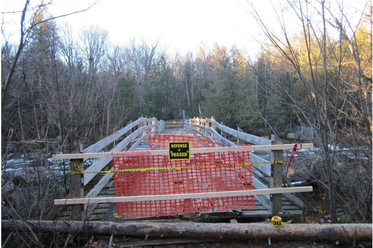
Figure 3.16 Photographie montrant le pont barricadé (2012)
