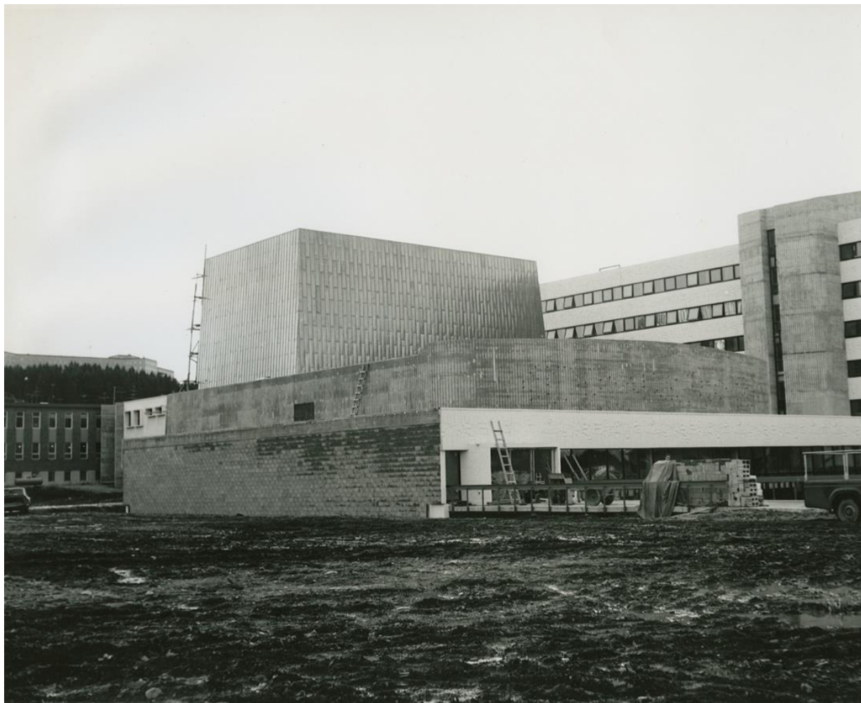
Figure 3.12, Photographie inconnue, Construction du Centre culturel de l'agrandissement du Foyer-Patro de Rivière-du-Loup , [1966?], Photographie, Centre d'archives de la région de Rivière-du-Loup, Rivière-du-Loup.
