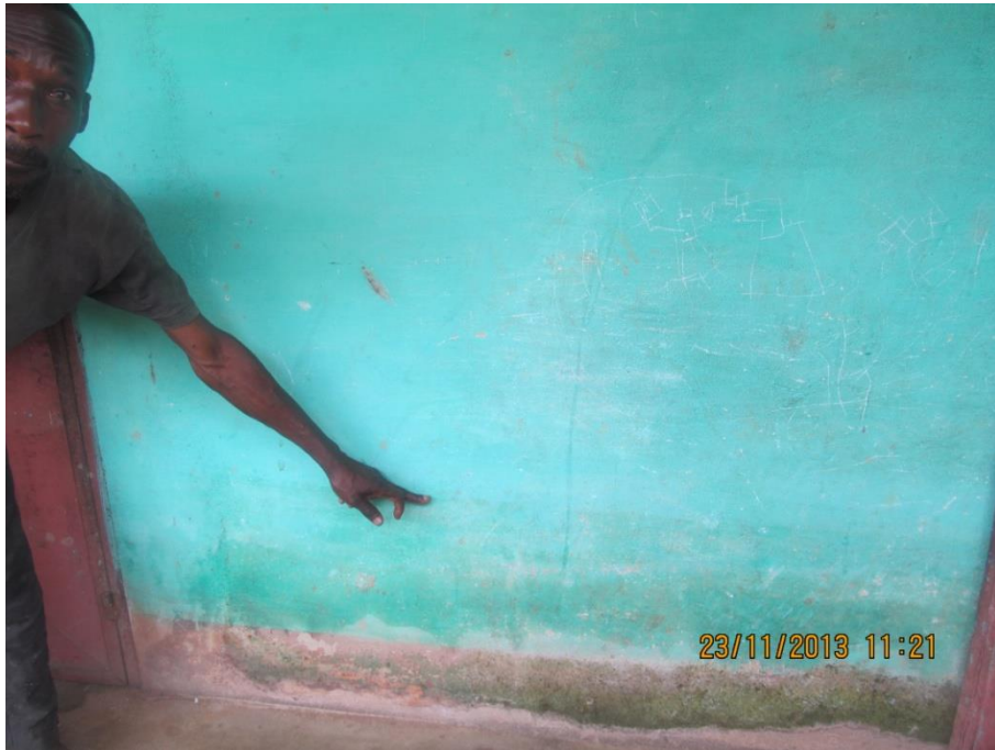
Niveau d'eau atteint en juillet 2012
